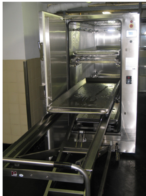
Automatisches Be- / Entladen der SprayCon-Anlage
