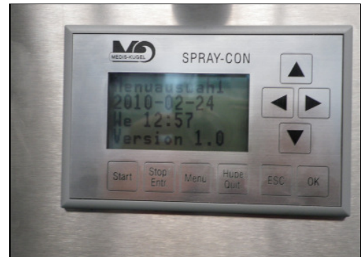
Steuerung der SprayCon-Anlage mit Warn-Meldung
