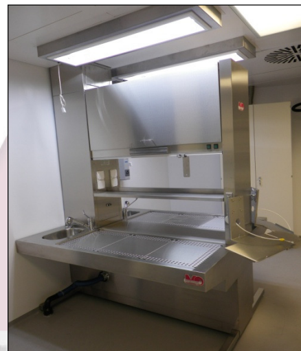
MA-2070 mit Überbau und Spezial-Deckenbeleuchtung
