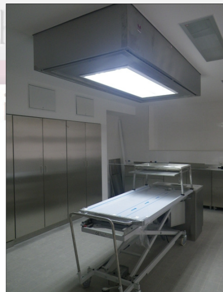
MA-2017 Zuluft-Element mit Beleuchtung in Zwischendecke eingelassen
