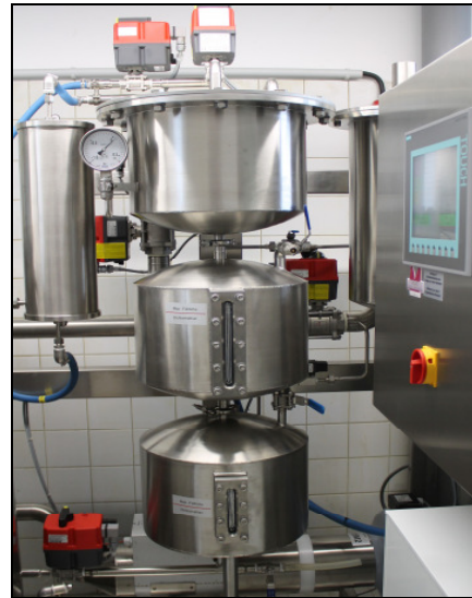
Dichlormethan-Rückgewinnungsanlage mit Kondensator und Vorratsbehälter
